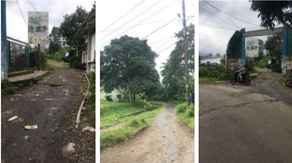
Gambar 1. Kondisi jalan desa di Desa Santong yang rusak
